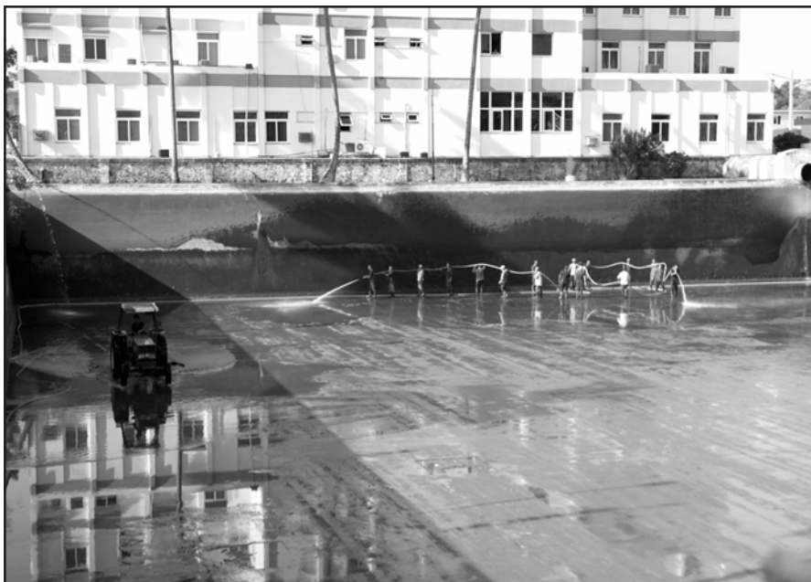
La limpieza de los Tanques de Palatino, garantía de la calidad del agua
