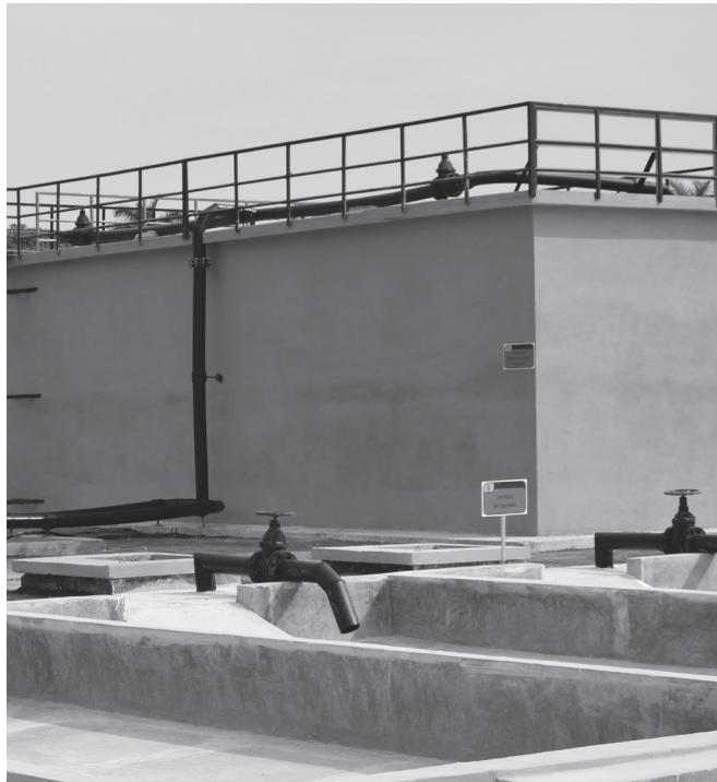
Tanque Sedimentador Digestor
