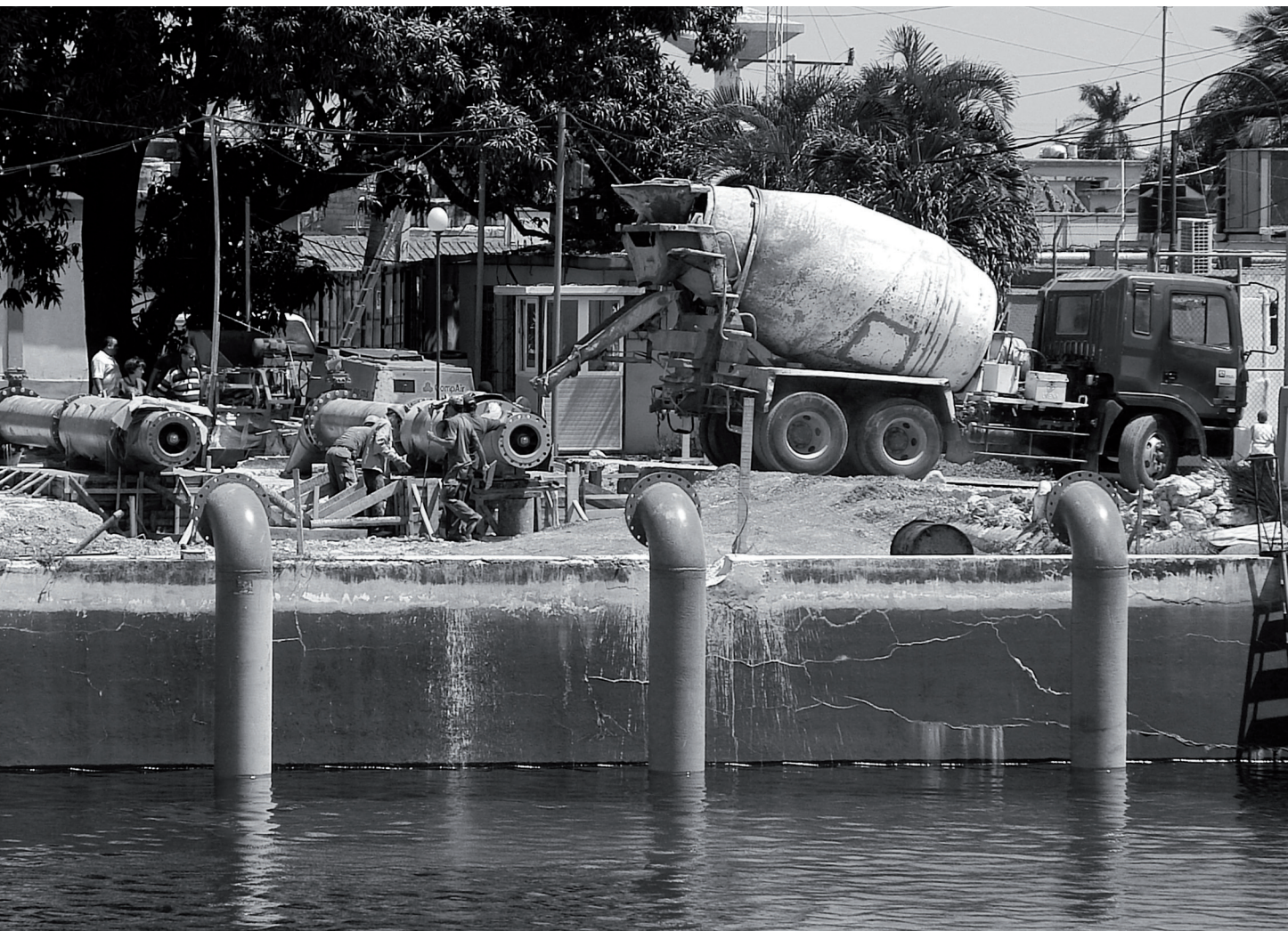
Tuberías de descarga de las bombas que se ubicarán dentro del Tanque de Palatino.
