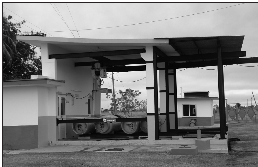
Eficiente sistema de cloración en Ariguanabo
