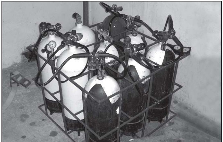
Sistema Estacionario de suministro de aire respirable
