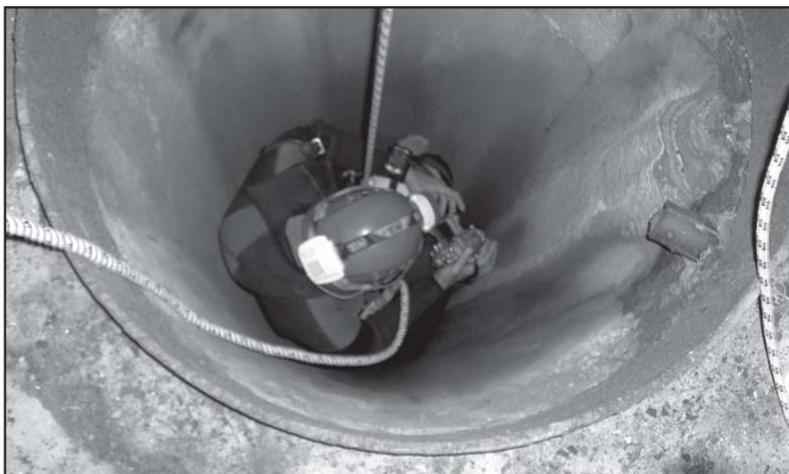
Pozo No.15 de la Fuente de Abasto Cuenca Sur
