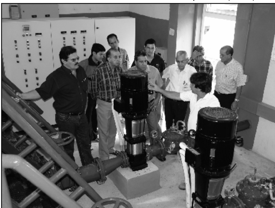
El Ing. Osvaldo Gómez explica a los visitantes el funcionamiento de la instalación.
