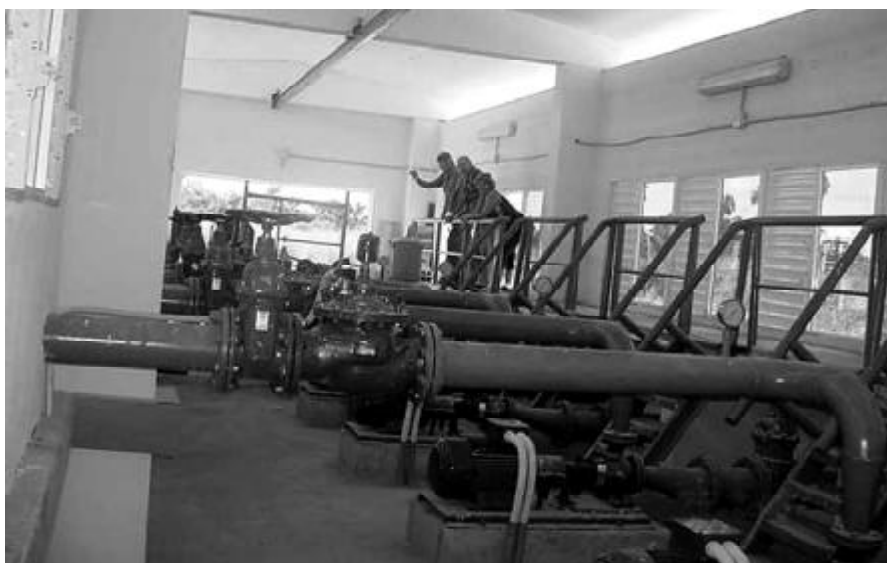
Estación de bombeo central.
