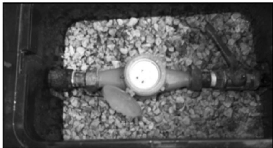
Nuevo metrocontador instalado.
