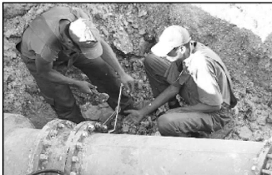
Trabajos en una de las Grandes Conductoras que abastecen al municipio Plaza.
