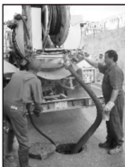
Extracción de residuales.
